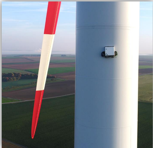
Radarsystem am Turm einer Windenergieanlage (siehe auch: Moll et al., PIER, 2018)
